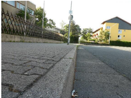
Abbildung 11: Radwegweisung und nicht abgesenkter Bordstein „Im Reis“
