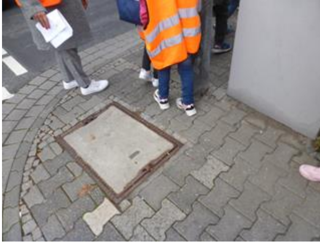
Abbildung 14: Abgesetzte Bordstein im Knotenpunktbereich Weisenauer Straße / Ludwigstraße
