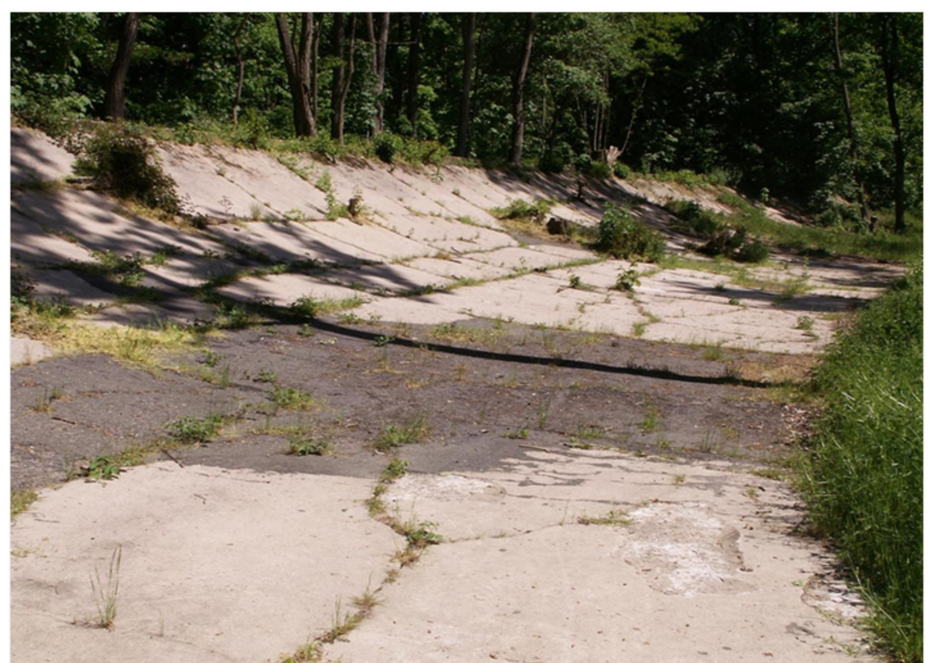
Zustand der Opelbahn 2019
