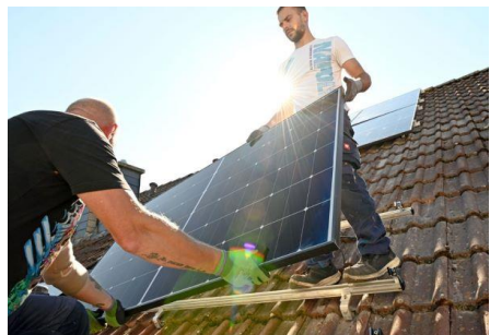
Abb. 9 Solaranlagen sparen CO 2
